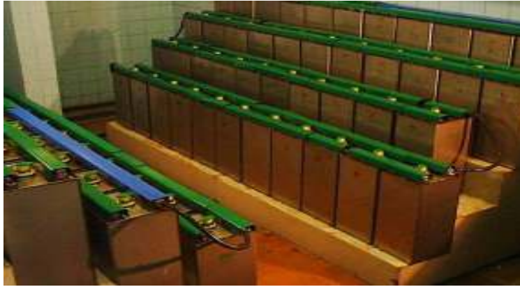
Gambar 15.13. Baterai Sumber Dc Gardu Induk
