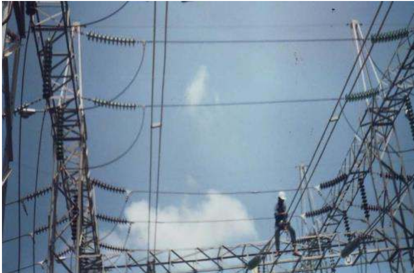
Gambar 15.9. Rel (Busbar) Pada GI Konvensional
