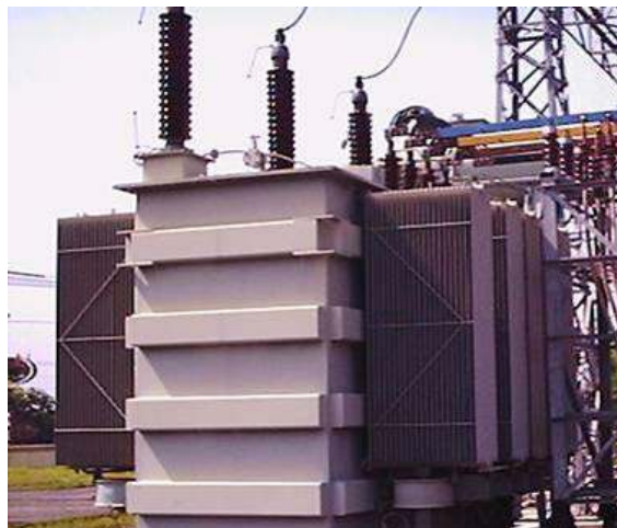
Gambar 15 4. Transformator Daya Pada GI Konvensional
