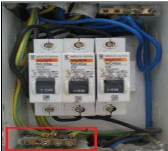
Gambar 3.7. Terminal Pentanahan di MCB Box
