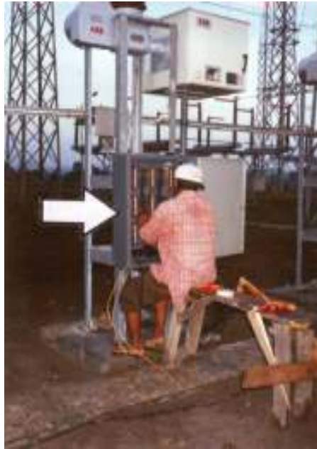
Gambar 15.25. Pekerja Tidak Pakai Pengaman
